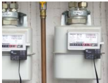
Impulszähler „Elster“ an Balgengasähler
